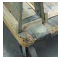
木材- 易碎裂和腐蚀
